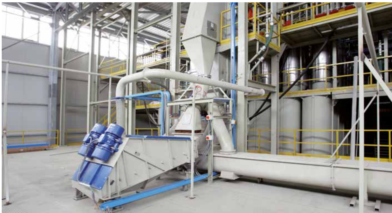
Installazione coclea CCU in impianto produzione adesivi in polvere
