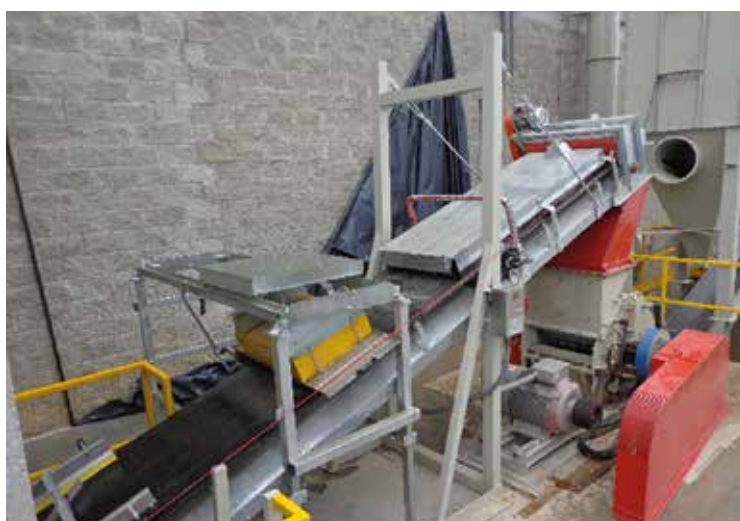
Controllo alimentazione mulino con deferrizzatore e metal detector Mill's feeding control with iron remover and metal detector
